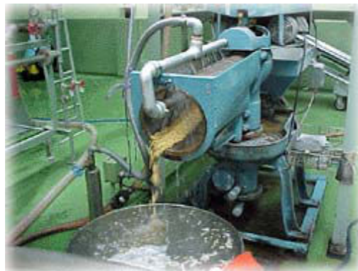
原料タンクに蓄えられていた大豆を【連続洗穀機】で洗浄する行程です
